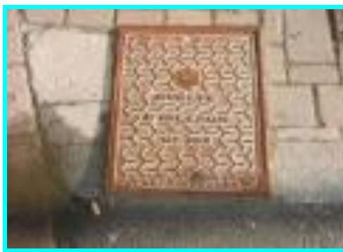
Capot de coffre d'une bouche incendie
