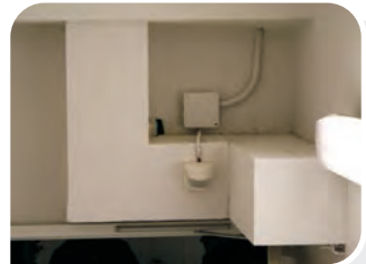
défaut d'isolation entre parc et SAS
