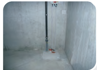
absence de protection de conduits
