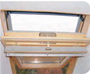
Absence d'entrée d'air permanente dans la pièce principale
