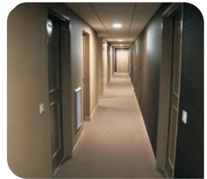
Défaut d'éclairage dans circulation commune
