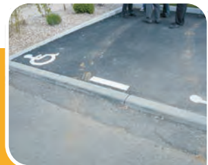
Place de stationnement inaccessible à cause du ressaut > 4 cm
