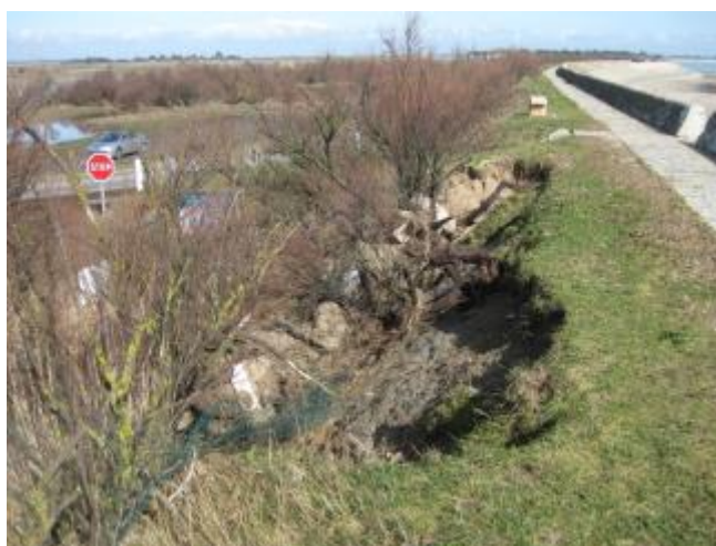
Figure 21 : Digue de l'île de Ré après Xynthia (photo ISL)
