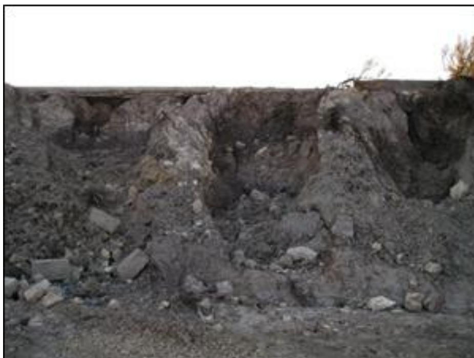
Figure 18 : Digue du polder des Champs après Xynthia (photo ISL)
