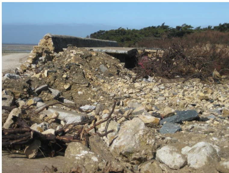
Figure 20 : Digue de l'île de Ré après Xynthia (photo ISL)
