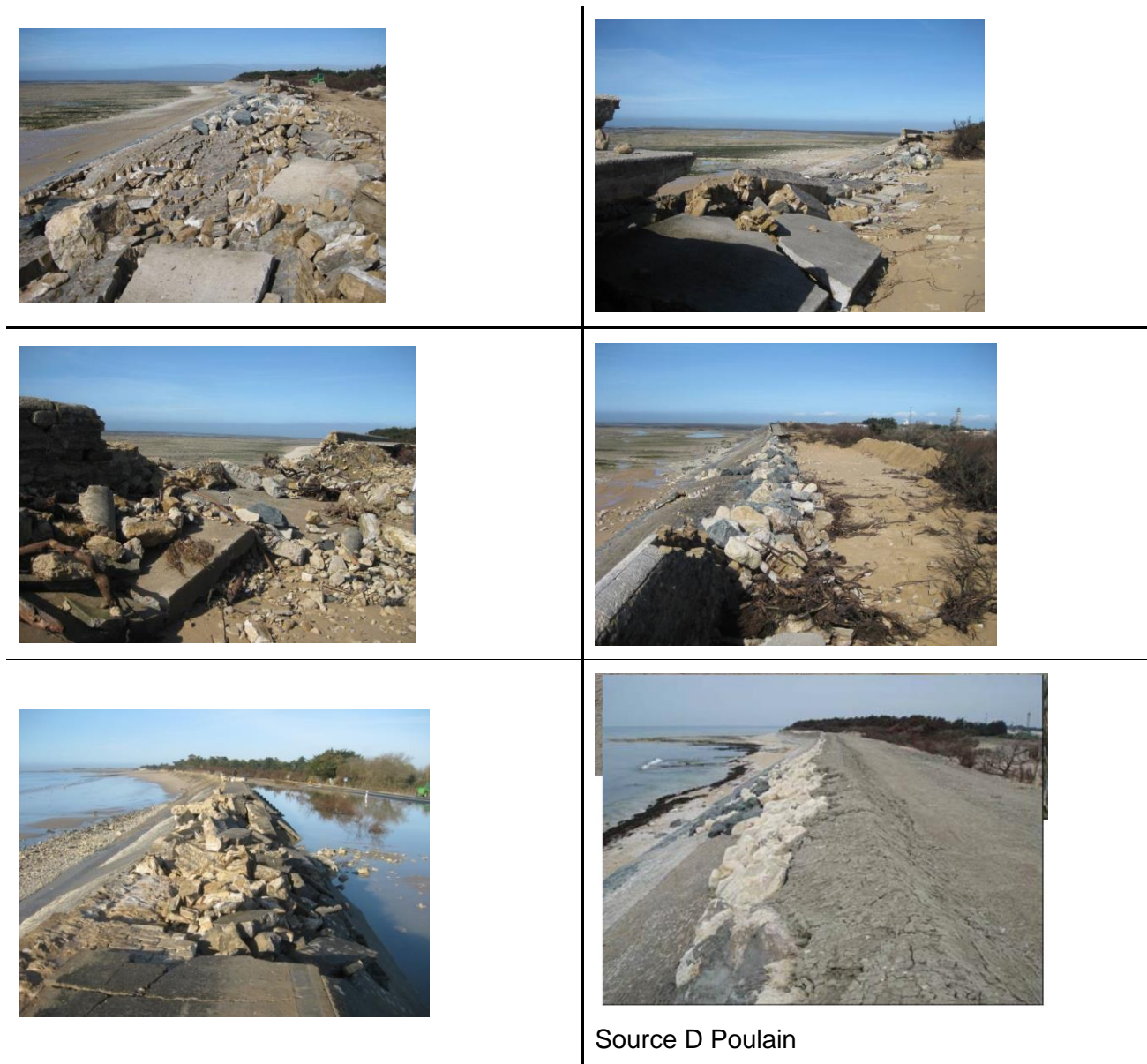
Figure 24 : dégâts sur les digues de l'île de Ré (photos ISL excepté dernière)
