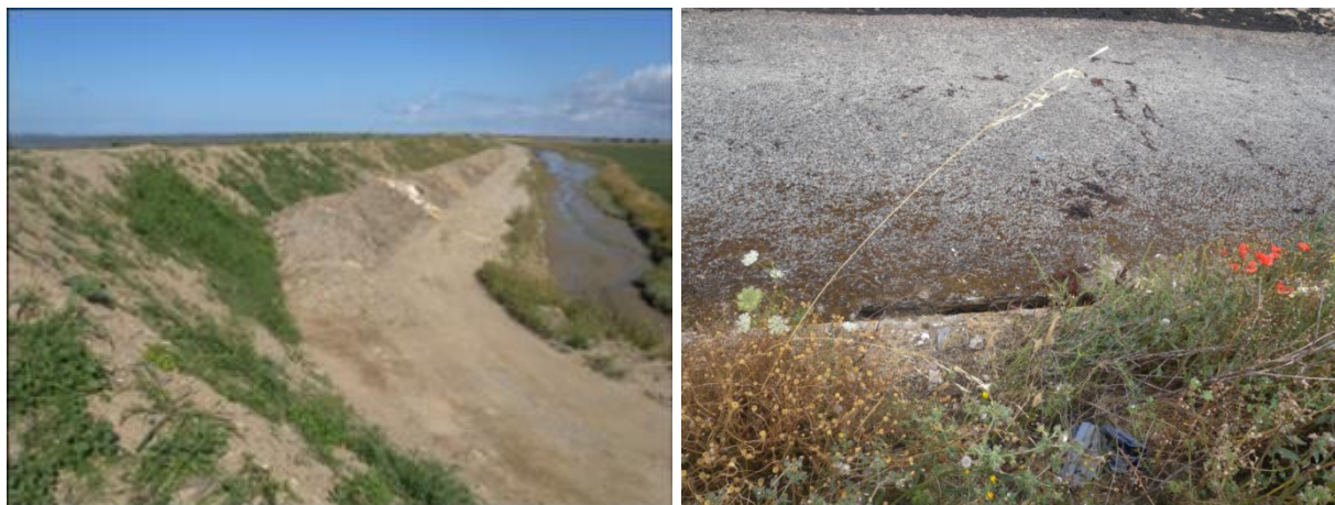
Figure 15 : digue des Glagées – surélévation à gauche ; dégradations à la transition béton-maçonneries côté mer. (source : EDD)
