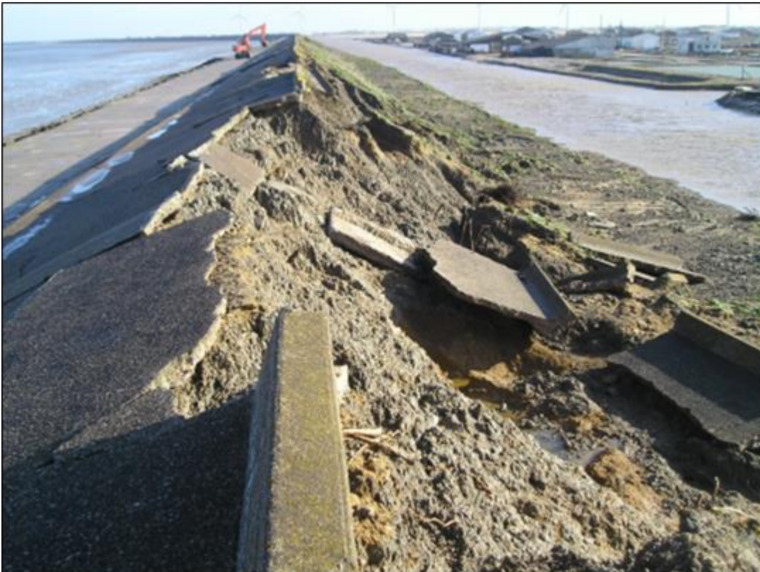
Figure 17 : digue du Dain après Xynthia (photo ISL)
