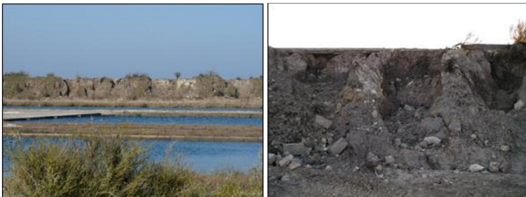
Figure 52 : érosion du talus aval de la digue de la Louippe – vue générale et détail.
