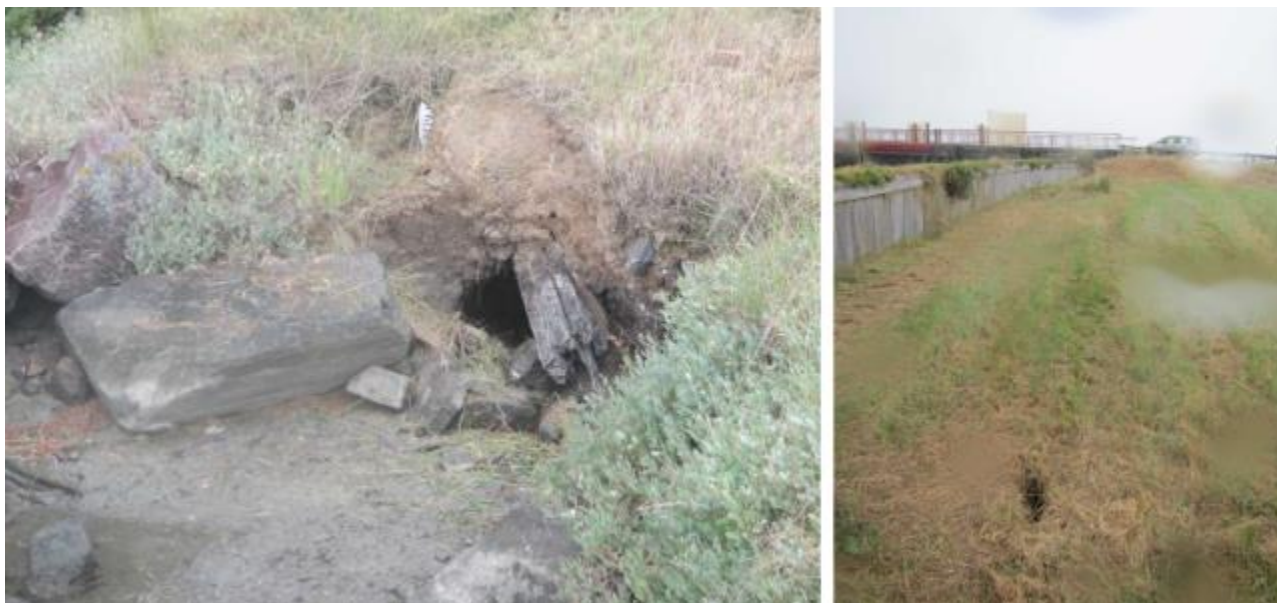
Figure 39: important fontis au droit de la prise d'eau – fond du port du Collet (photo ISL)
