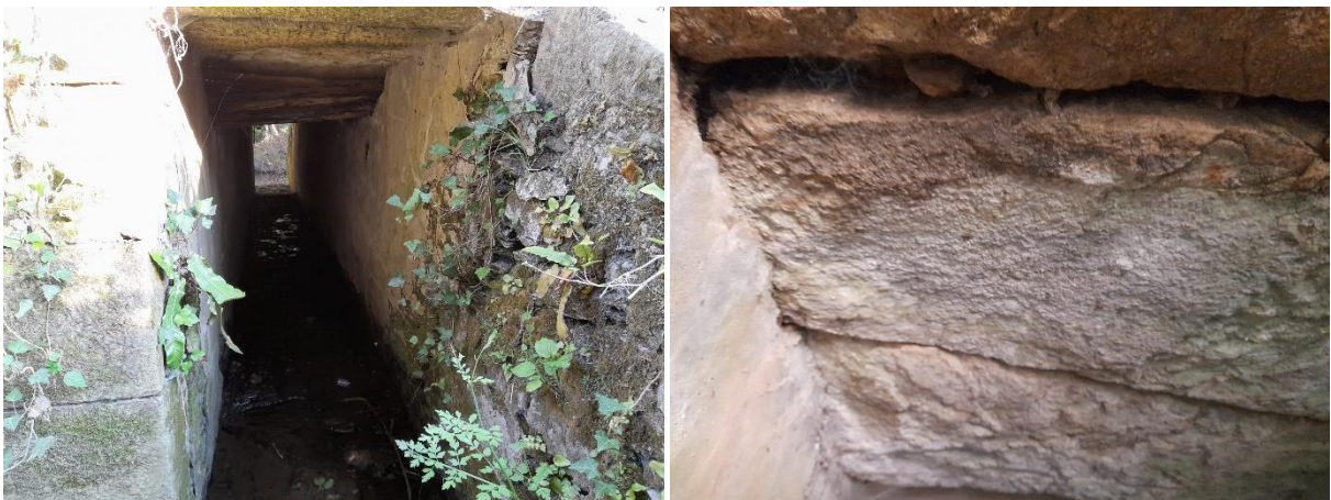
Photographies de la voûte de droite montrant des gîtes potentiels sous forme d'interstices entre les pierres de la voûte
