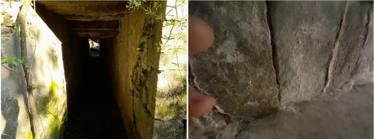
Photographies de la voûte de gauche montrant des gîtes potentiels sous forme d'interstices entre les pierres de la voûte
