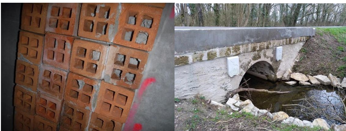
Exemple de gîtes artificiels en brique installés sous un ouvrage de franchissement d'une 2 x 2 voies dans le département de Vendée (à gauche) ou à l'entrée d'un ouvrage de franchissement sur une route départementale (à droite)
