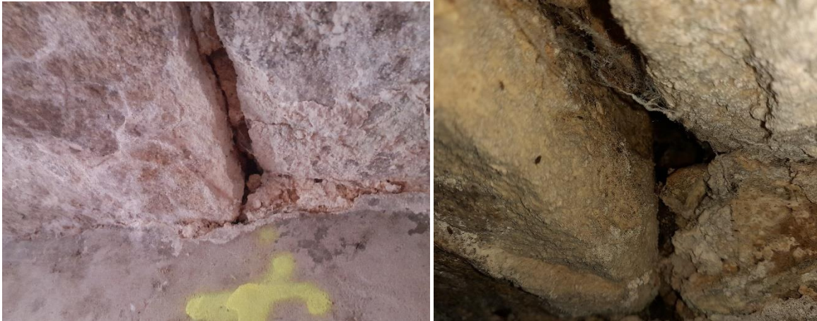
Photographies d'une fissure favorable à la présence de chiroptères (à gauche) et de l'anfractuosit  occup e lors du passage en juin 2023)
