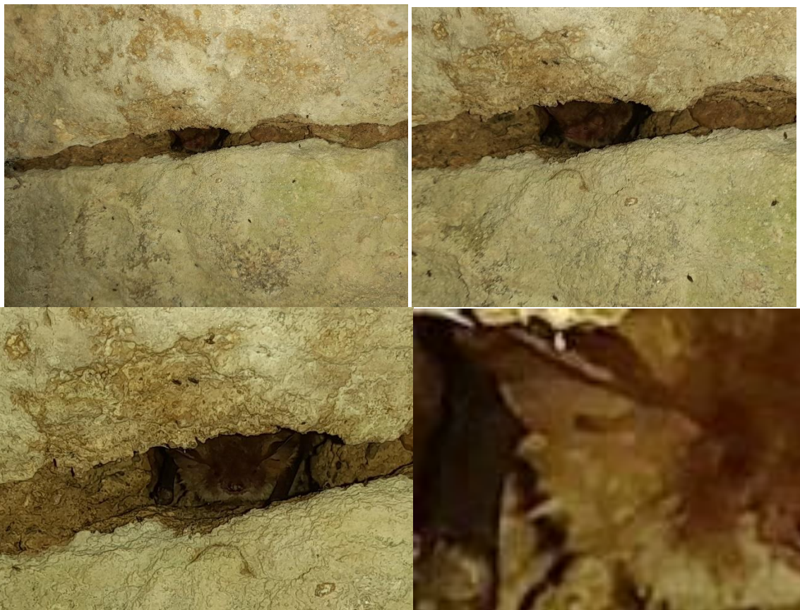
Photographies d'une fissure favorable à la présence de chiroptères, occupée lors du passage effectué en juin 2023, et zoom sur le tragus ( en bas à droite)
